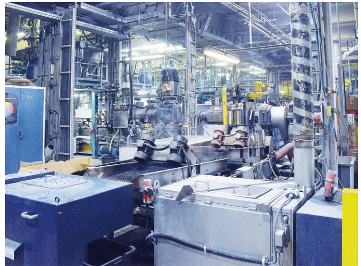
Am Aufbereitungsstandort von Vogt Plastic in Rickenbach-Hottingen sind zwei „aufgepeppte“ Compoundierlinien im Einsatz – beide mit Leistritz-Extrudern.
