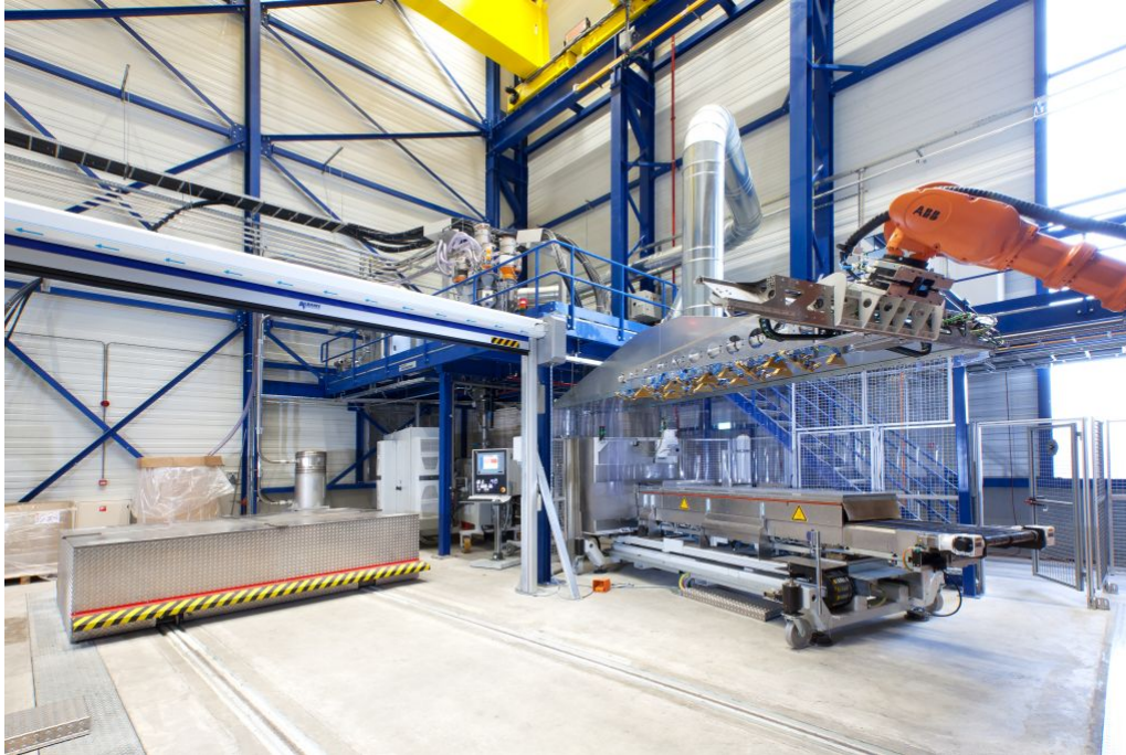
Ein Blick in die LFT-Anlage bei Dieffenbacher
